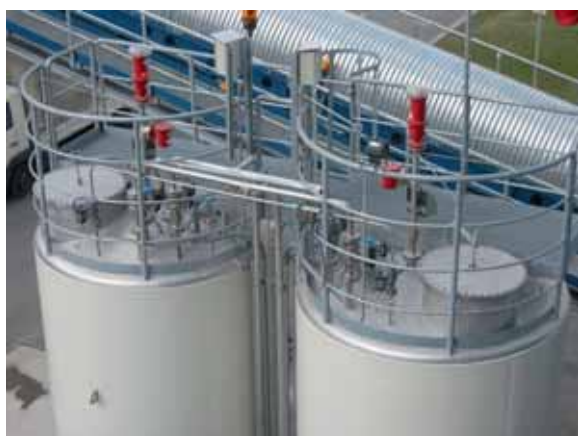
Bild 7: Lagerbehälter für Ammoniakwasser
