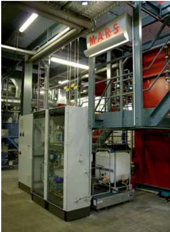
Bild 13: Misch- und Messmodul mit 500 l-Lagerbehälter
