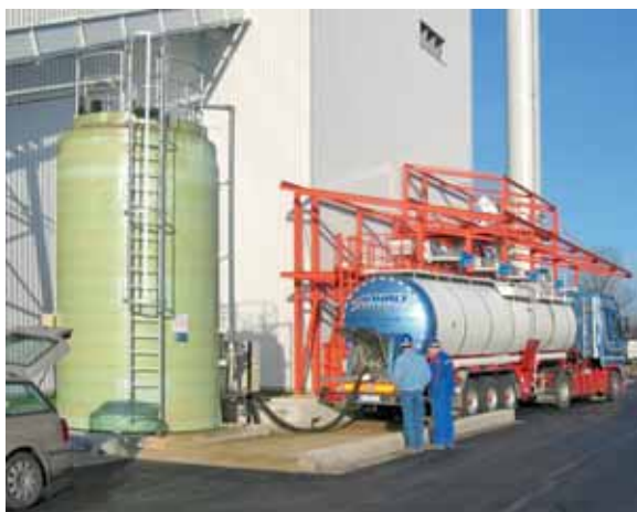
Bild 4: Lagertank für Harnstofflösung
