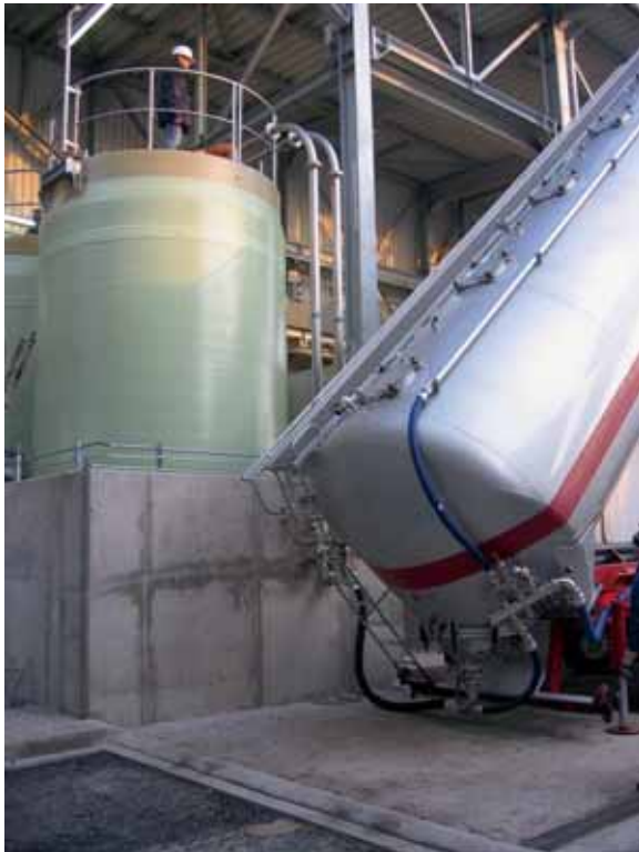
Bild 5: Anmischstation und Lagertank für Harnstofflösung
