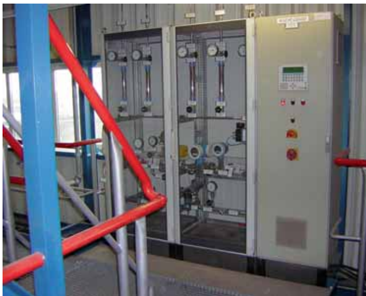
Bild 9: Misch- und Messmodul mit MSR-Schrank für Harnstofflösung
