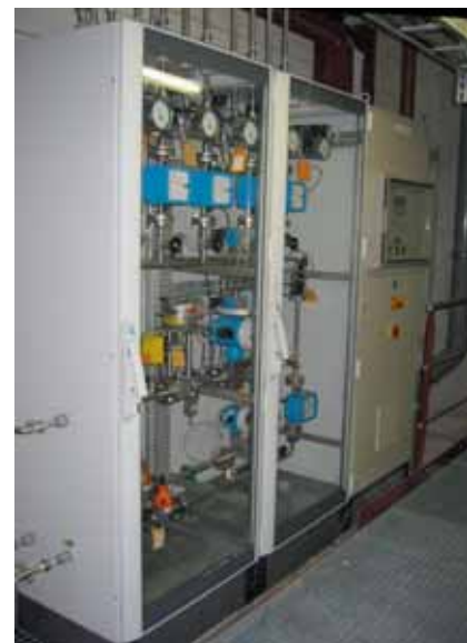
Bild 10: Misch- und Messmodul mit MSR-Schrank für Ammoniakwasser
