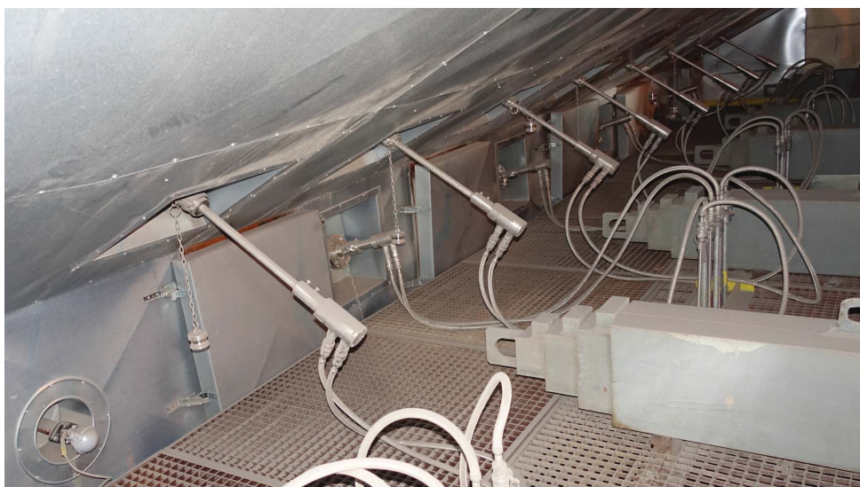
Abb. 8: Eindüsung durch die Kesselrückwand in einem Kohle gefeuerten Kessel
