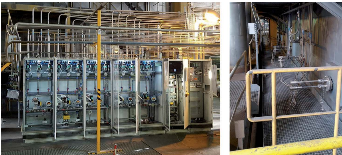
Abb. 13: Standort B – Misch- und Messmodul (links), Eindüslanzen (rechts)
