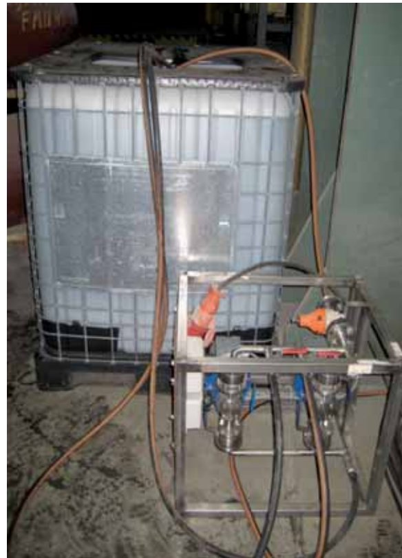
Bild 4: Demonstrationsanlage: NOxAMID-Behälter, Pumpenmodul
