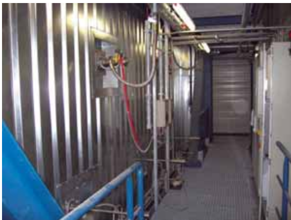
Bild 6: SNCR-Eindüslanzen mit akustischer Temperaturmessung
