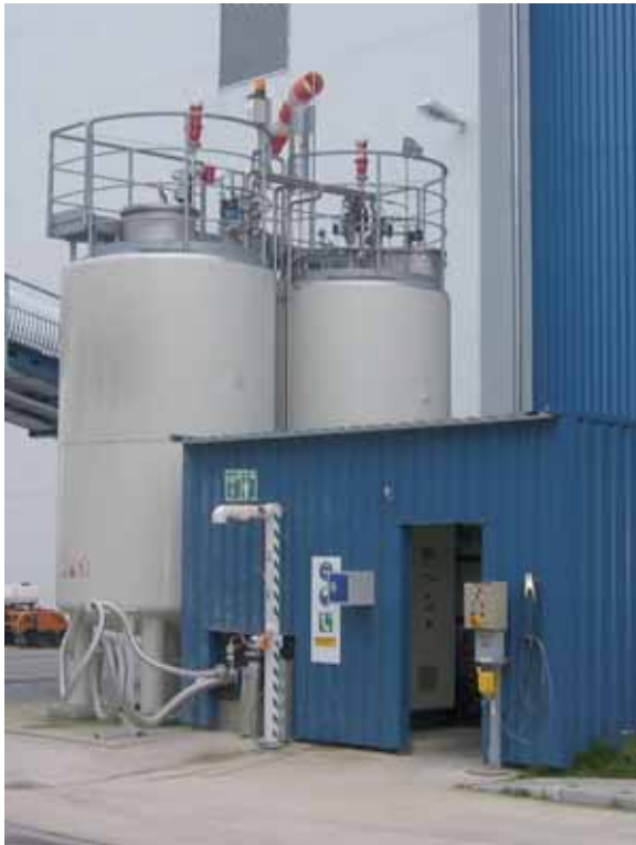
Bild 12: Tanklager für Ammoniakwasser mit Pumpenstation
