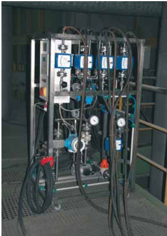
Bild 3: Demonstrationsanlage: Misch- und Messmodul
