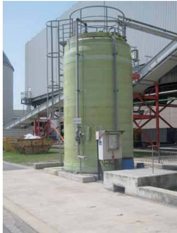
Bild 13: Tanklager für Harnstofflösung
